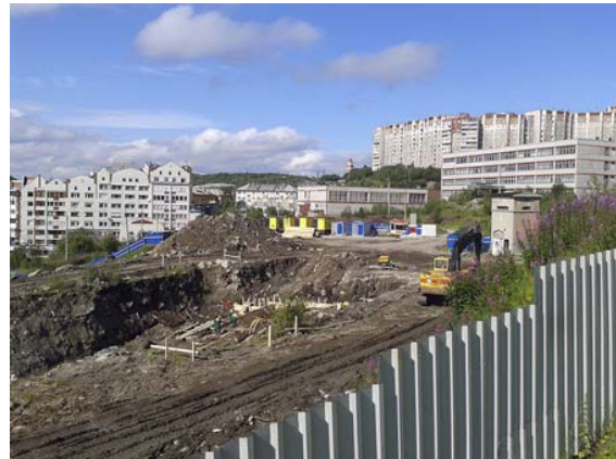
Ảnh 1: Xây dựng công trình ngầm đô thị bằng phương pháp đào mở lộ thiên
